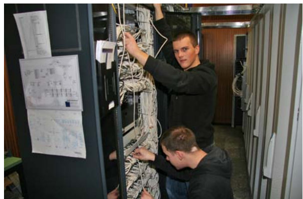
Abb. 3: Patchen von Netzwerkverbindungen
