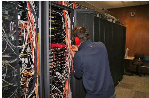
Abb. 5: Servereinbau in ein 19“-Rack
